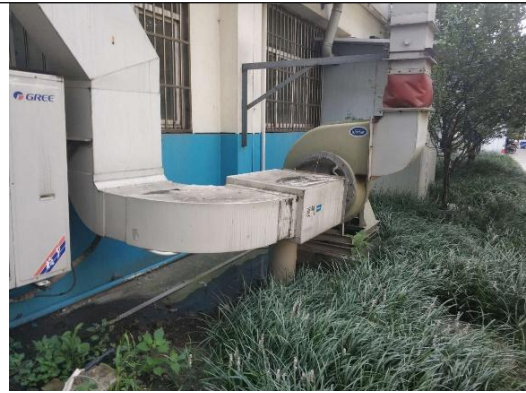
废气处理装置
