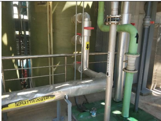
废液输送管道
