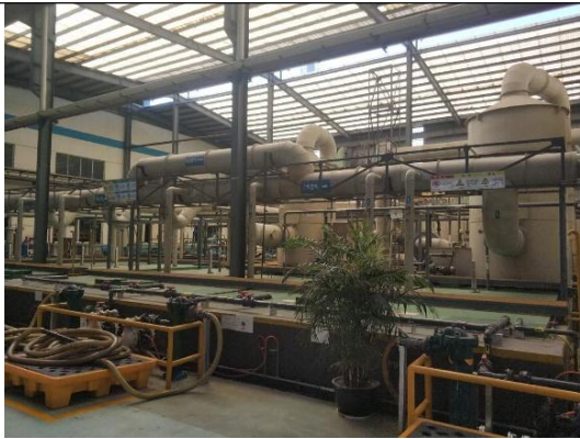
废气处理装置
