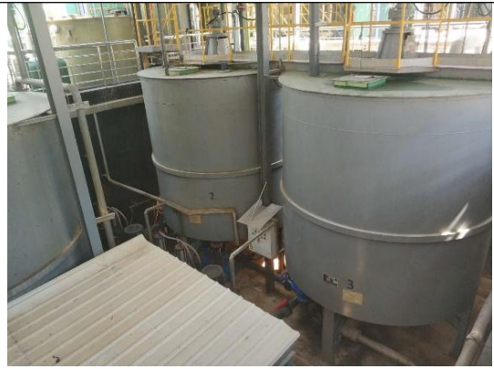
废水处理装置
